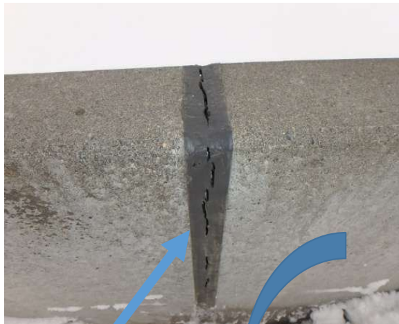
2年経過ひび割れ発生
