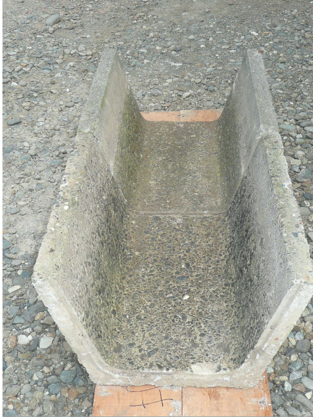
摩耗により骨材が露出水路
