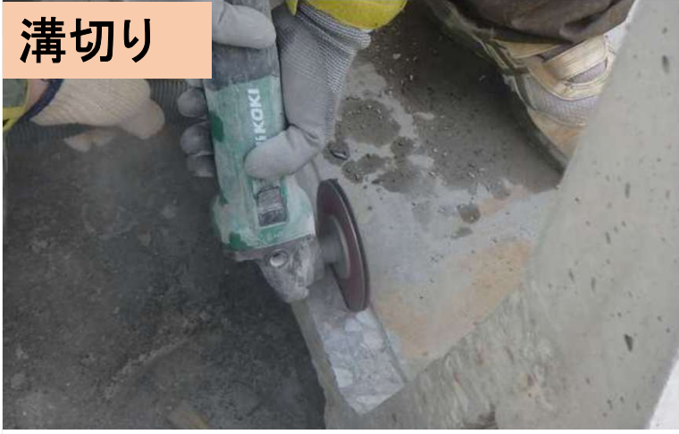
DFTカッターによる溝切りにおいて、作業効率の低下は確認されなかった。
