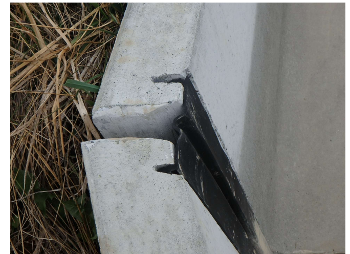
目地間隔の広がり
