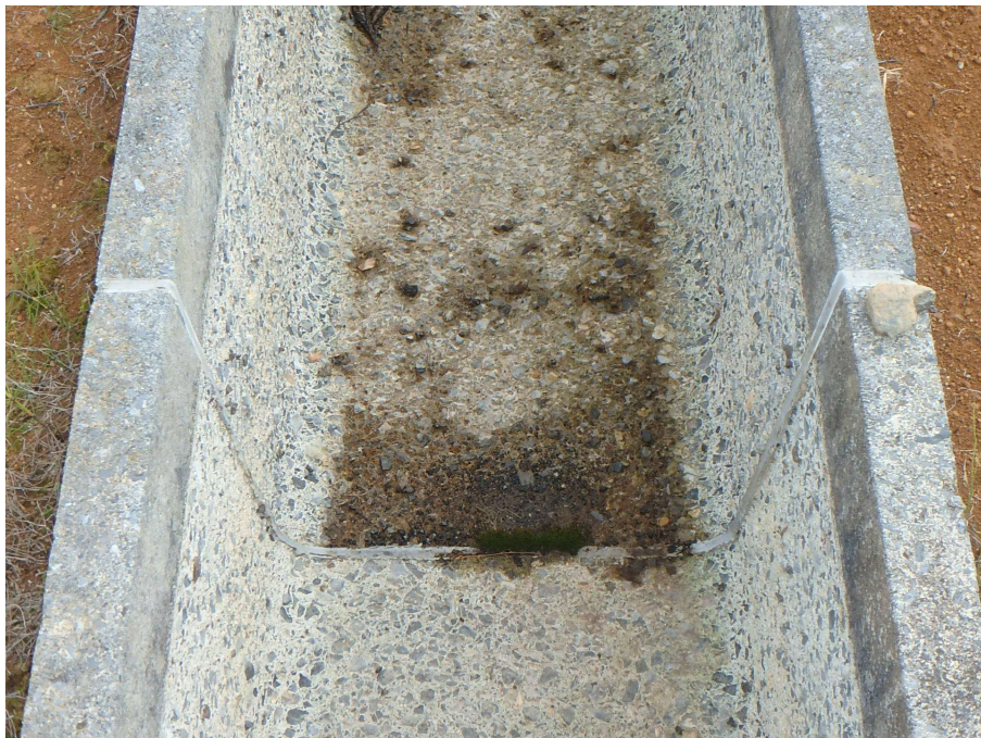
摩耗により骨材が露出水路
