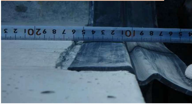
切欠部にDFTジョイントが収まり水路内部への突出は無くなった
